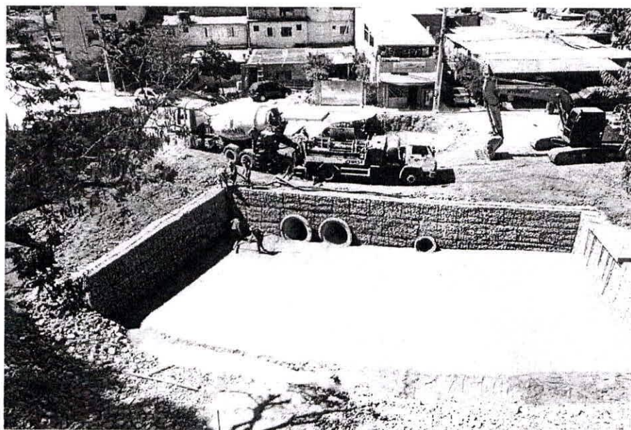
Tanque de captação
