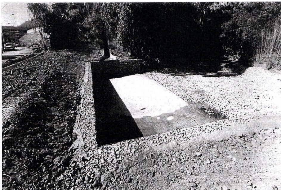
Tanque de captação
